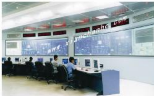
● 上图所示为深圳妈湾电厂集控室，其中六面数码显示屏选用了我公司生产的CH-92S数码管式工业参数显示器，该屏自1995年使用至今。
