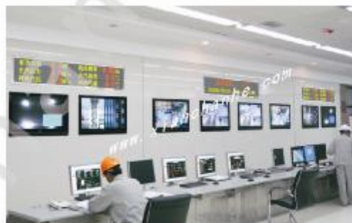
● 上图所示为辽宁中电抚顺电厂 2 \times 300\text{MW} 机组集控室，其中两面机组参数点阵屏、一面时钟点阵屏均为我公司生产的CH-92D点阵式脱机显示屏，该屏承制于2008年。
