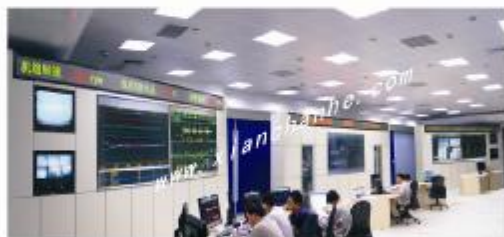
● 上图所示为广西防城港电厂2×600MW机组集控室，其中三面点阵显示屏选用了我公司生产的CH-92T点阵式同步显示屏，该屏承制于2006年。
