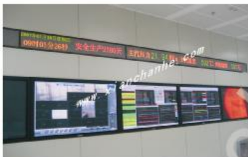
● 上图所示为山东华电邹县电厂 2 \times 1000\text{MW} 机组集控室，其中两面机组参数点阵屏、一面时钟点阵屏均为我公司生产的CH-92D点阵式脱机显示屏，该屏承制于2006年。
