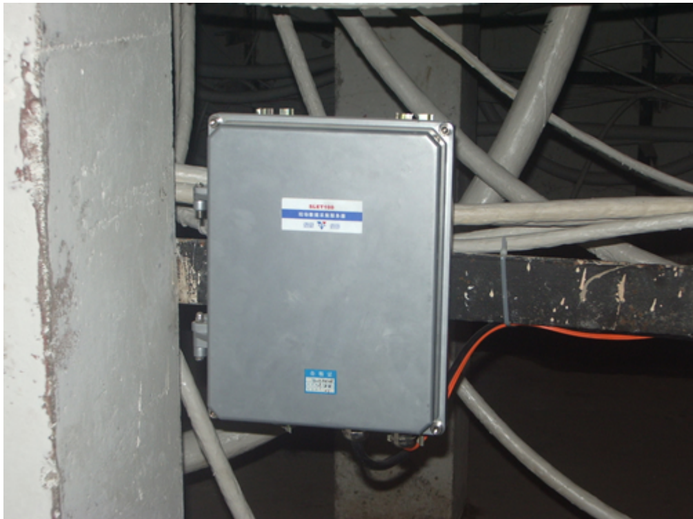
在某电厂运行中的数据采集服务器
