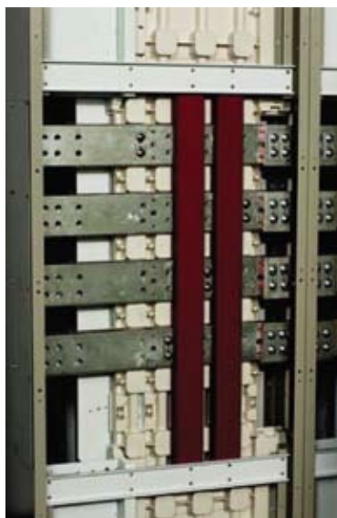
图12 位于水平母线上侧的中性线（背视图）
