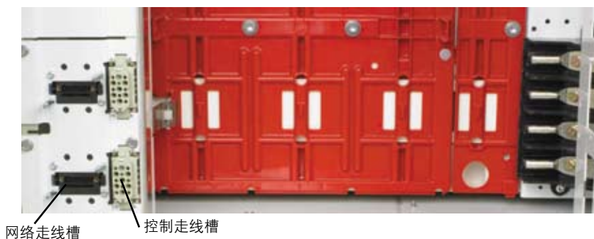
图9 控制和网络走线槽
