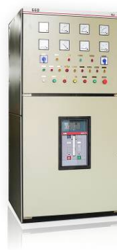
ATS (双电源切换开柜)
