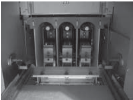
电缆室 (断路器抽出时)
