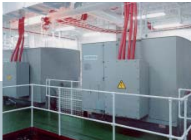
电机机房 - 每台 3 MW
