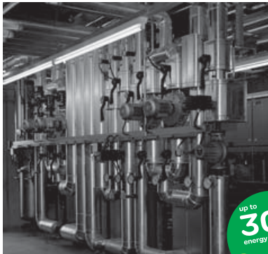
ATV 12 控制泵站 (▲)
