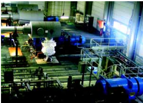
将中压变频器安装到5个泵中的2个向油轮罐提供返回气体的压缩机上。压缩机和冰位于图片中央。
