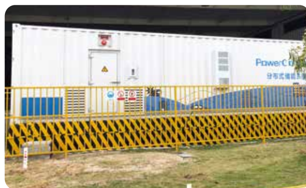
安装地点: 广东 项目容量: 500kW/1.8MWh 机器型号: BD500KTR-T
