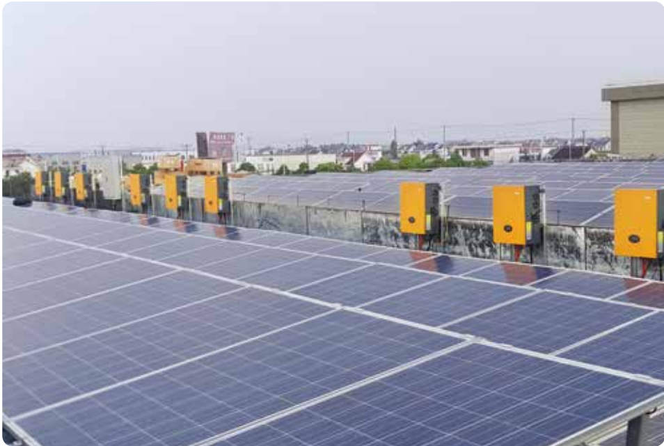
安装地点：江苏-如东 项目容量：3MW 机器型号：BG30KTR
