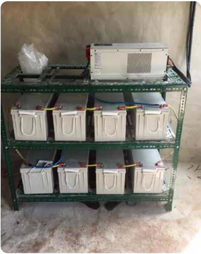
安装地点：尼日利亚 项目容量：6kW 机器型号：BN1024C
