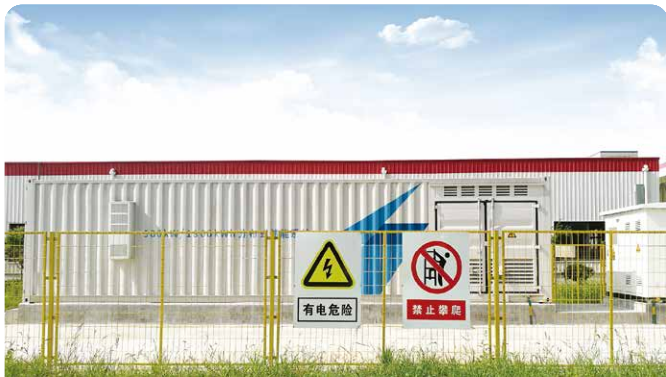
安装地点: 江苏 项目容量: 500kW/1.8MWh 机器型号: BD500KTR-T
