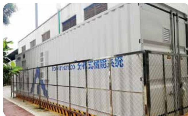
安装地点: 东莞 项目容量: 500kW/1.5MWh 机器型号: BD500KTR-T
