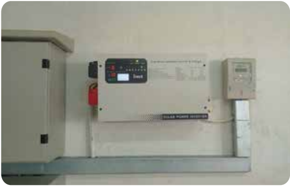
安装地点：泰国 项目容量：1kW 机器型号：BN1024C
