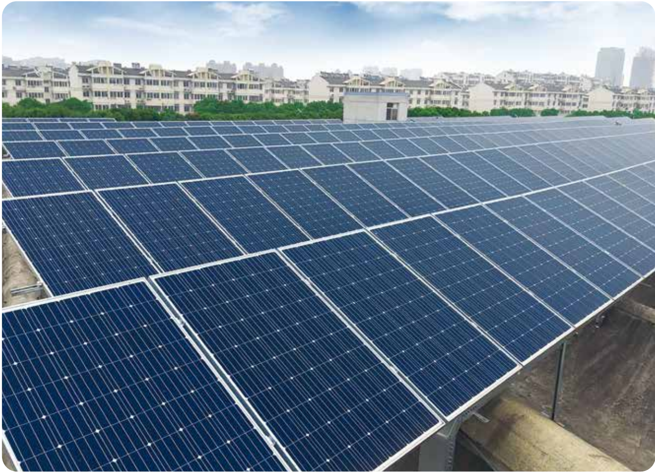
安装地点：江苏-常州 项目容量：500kW 机器型号：BG35KTR
