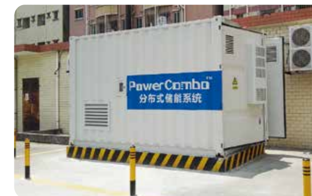
安装地点: 东莞 项目容量: 500kW/300kWh 机器型号: BD500KTR
