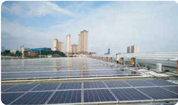
安装地点：湖南-长沙 项目容量：1.8MW 机器型号：BG33KTR
