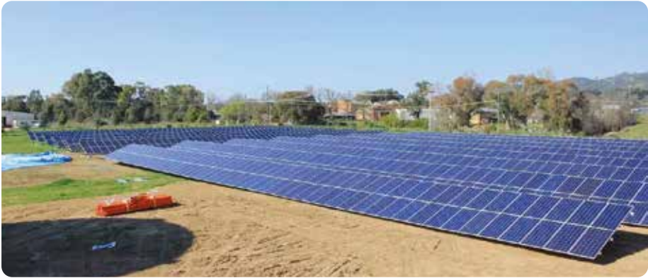
安装地点：澳大利亚 项目容量：2.3MW 机器型号：BG35KTR
