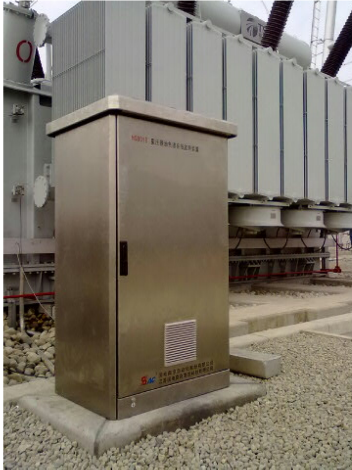
图 3 现场运行装置
