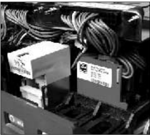
图3 已安装的分励脱扣器
