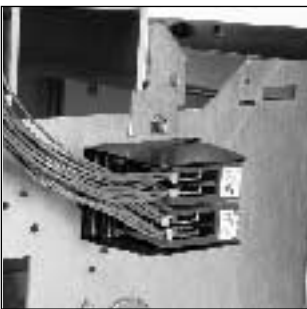
图15 位置开关安装在抽屉座上
