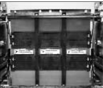
图12 安全挡板在开关位置
