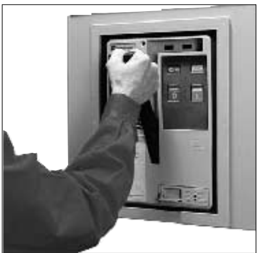
Magnum 断路器正在进行手动储能
