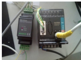
左边为变频器,右边为PLC.变频器上端为传感器接口,下端为电源和通讯接口.PLC黄色圆头为PORT0,另一个DB9为PORT2.具体接线请按照各自厂家说明书操作。需要说明的是,PLC的PORT0不支持modbus协议。
