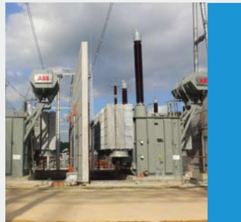
重庆ABB——无锡惠泉变扩建工程 ODFS – 334MVA/500KV Chongqing ABB-Huiquan, Wuxi, Variable expansion project ODFS 334MVA/500KV
