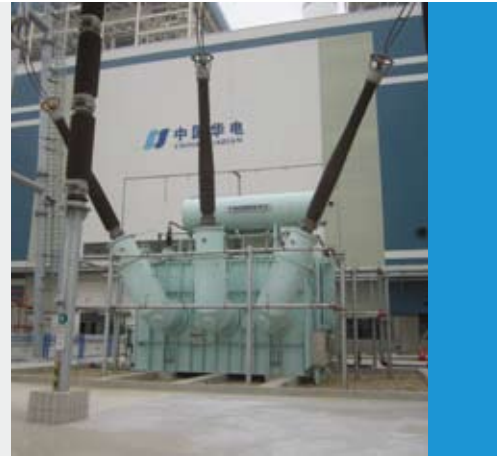
沈变——莱州 DFP-380MVA/500KV Shenyang transformer-Laizhou DFP-380MVA/500KV
