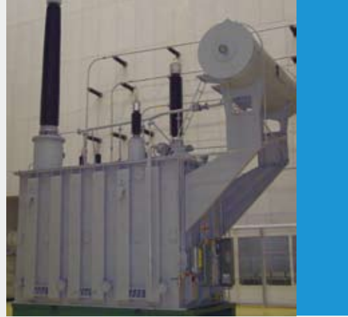
山东电力—— 出口越南 ODFPSZ-150MVA/500KV Shandong Electric Power-export to Vietnam ODFPSZ-150MVA/500KV
