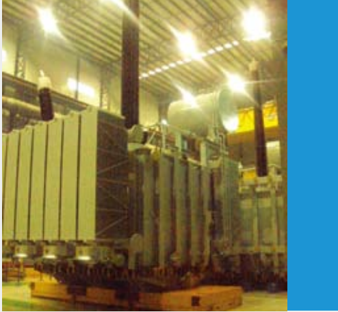
阿尔斯通——出口哥伦比亚 ODFSZ-150MVA/500KV ALSTOM-export to Columbia ODFSZ-150MVA/500KV
