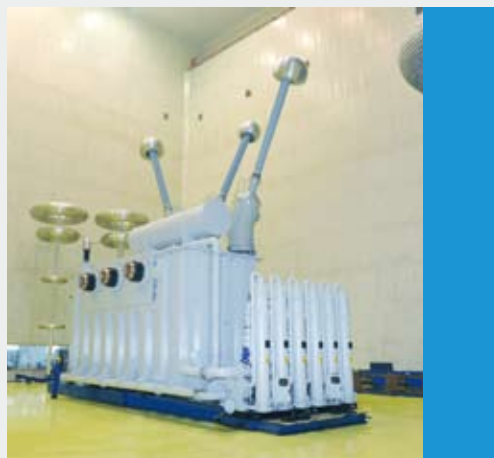
保变——向家坝水电主变压器 SSP-890MVA/500KV Baoding Tianwei-Xiangjiaba hydropower main transformer SSP-890MVA/500KV
