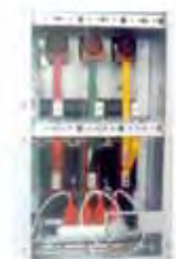
C 电缆室 Cable chamber
