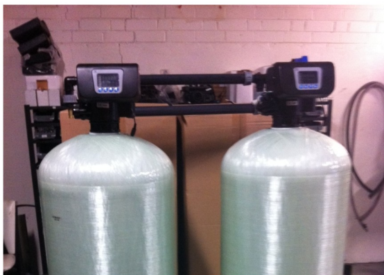
● 使用润新F63C自动软化阀(澳大利亚) ● 用于锅炉供水
