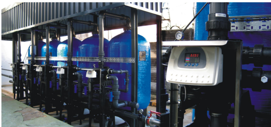
● 使用润新F78B自动过滤阀, 产水量80m³/h ● 除铁/过滤 ● East Midlands 公司(南非)
