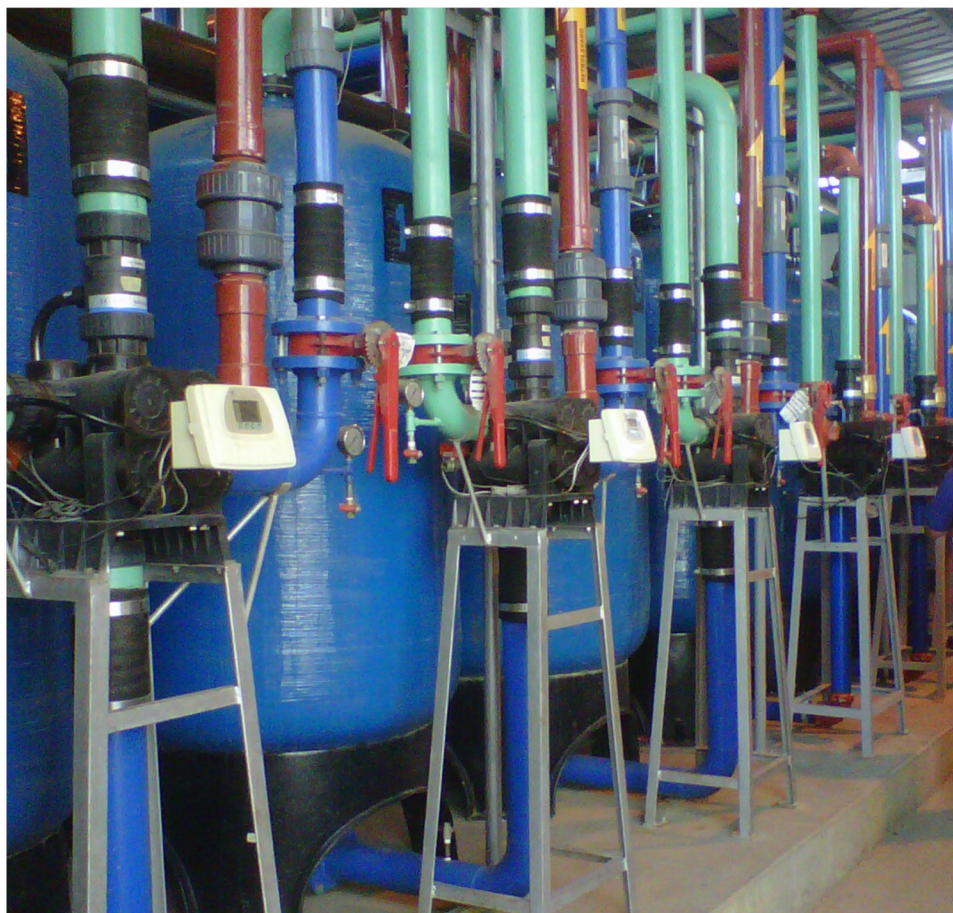
● 使用润新F78A 自动软化阀 ● 产水量250m 3 /h的过滤系统(危地马拉)
