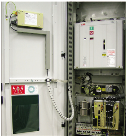
图 4 安装在低压室内的主机单元和门板上的 HMI
