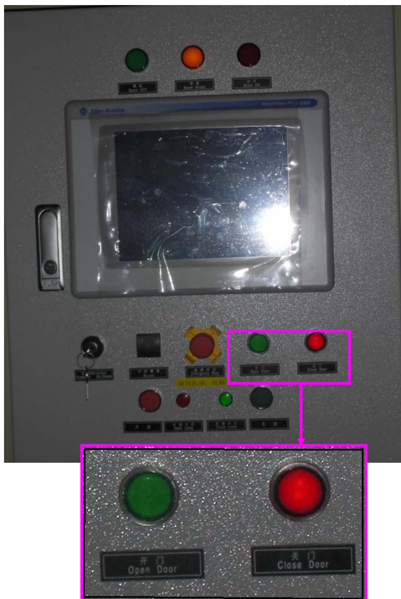
图2 棚屋外控制面板及开门关门按钮
