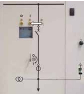
图 12：断路器机械合闸操作孔
