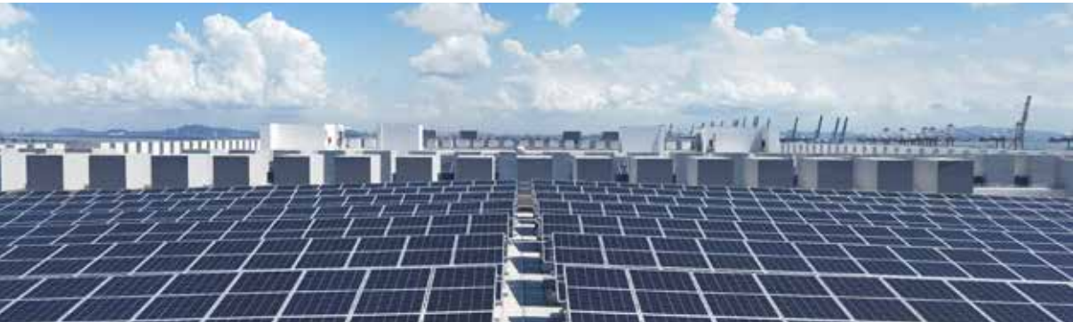
南沙国际物流中心光伏发电
