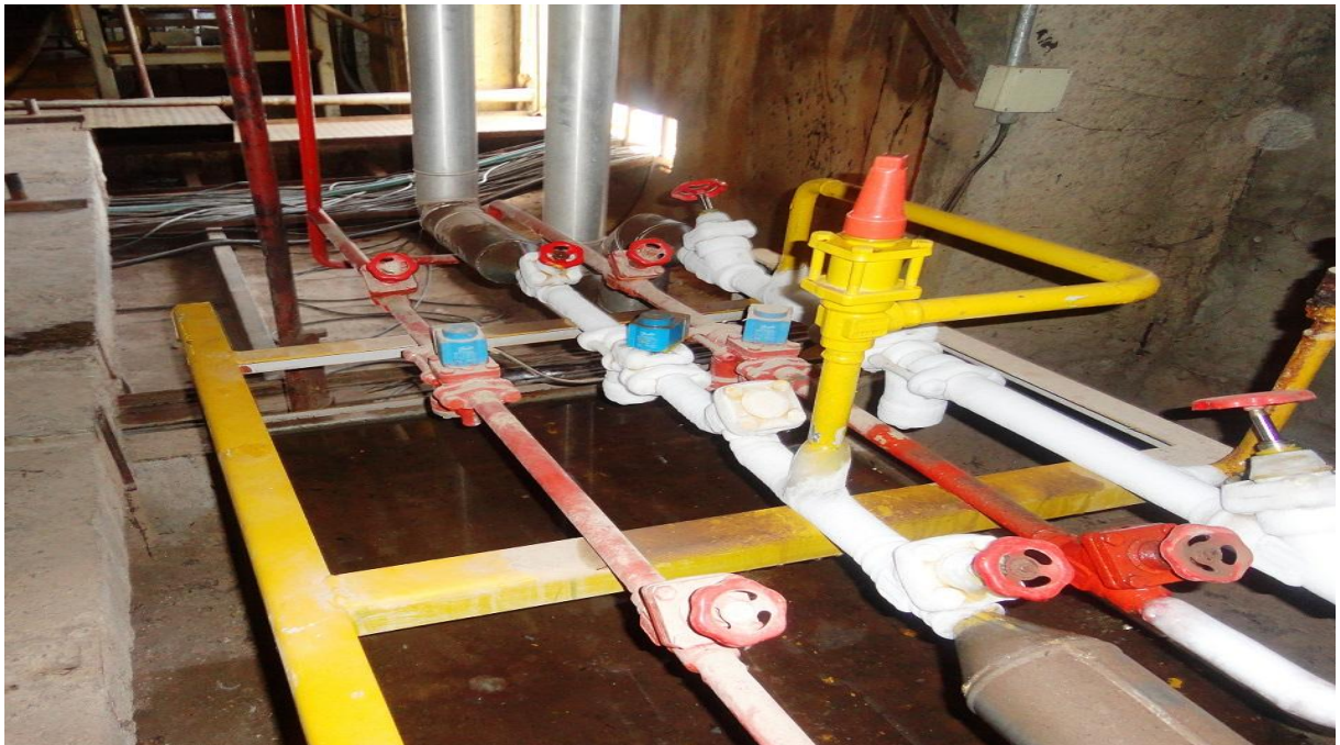
Figura 64 – Acidente atendido pelo CBMGO envolvendo gás refrigerado amônia em edificação industrial de alimentos em Senador Canedo/GO.
