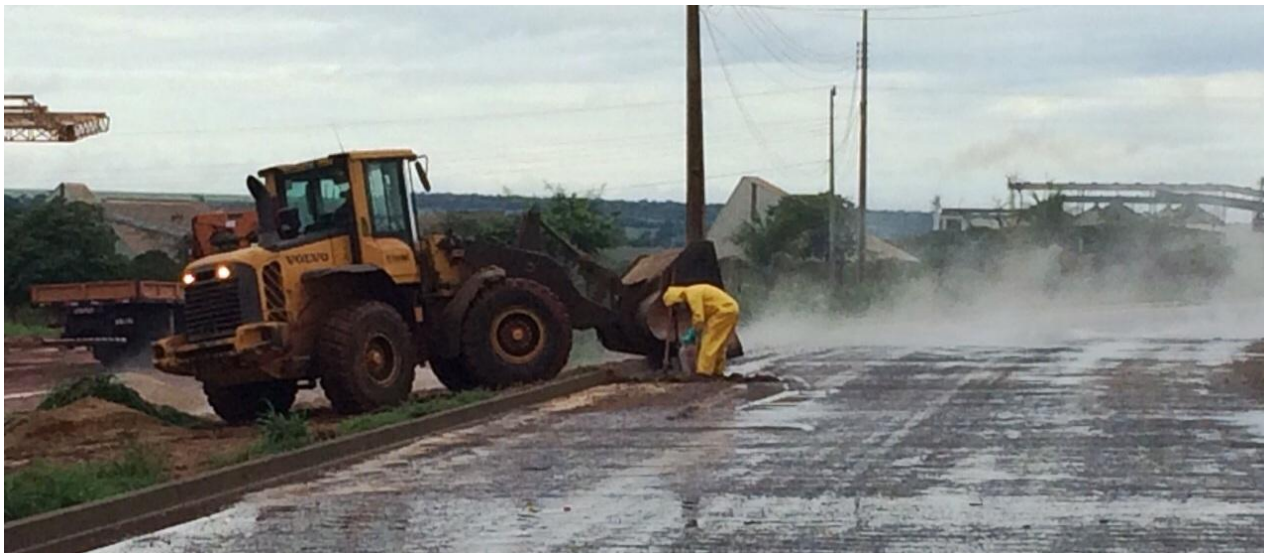
Figura 37 – Acidente atendido pelo CBMGO em Quirinópolis envolvendo ácido clorídrico, com o uso de pá mecânica na contenção.
