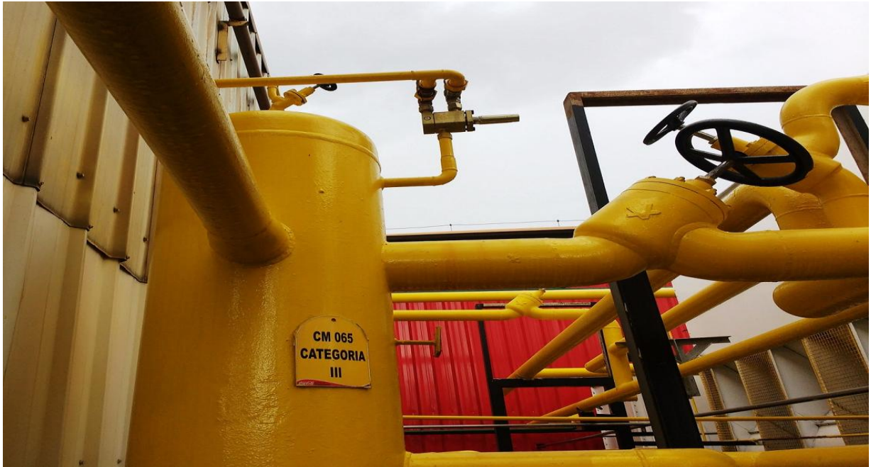
Figura 65 – Tubulações e válvulas externas envolvendo a manipulação de gás tóxico amônia, edificação industrial de refrigeração – Trindade/GO. Fonte: Wanderley Valério Oliveira.
