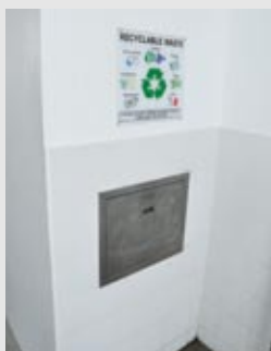
可循环垃圾槽
