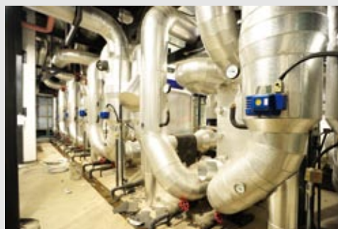
集中供冷系统
