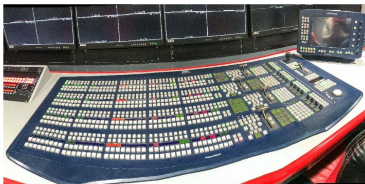
Figura 25 - Superficie de control 4 M/E y GUI instalados en la Unidad Móvil
