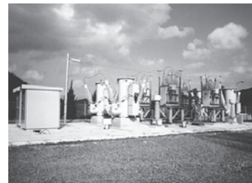
配電自動化システム
