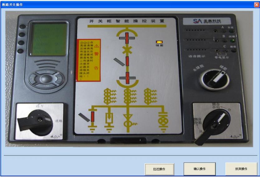
图 2-29 拉近后的断路器开关操作界面 2
