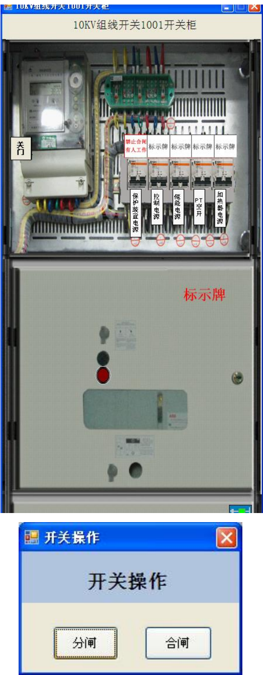
图 2-75 组线开关柜操作
