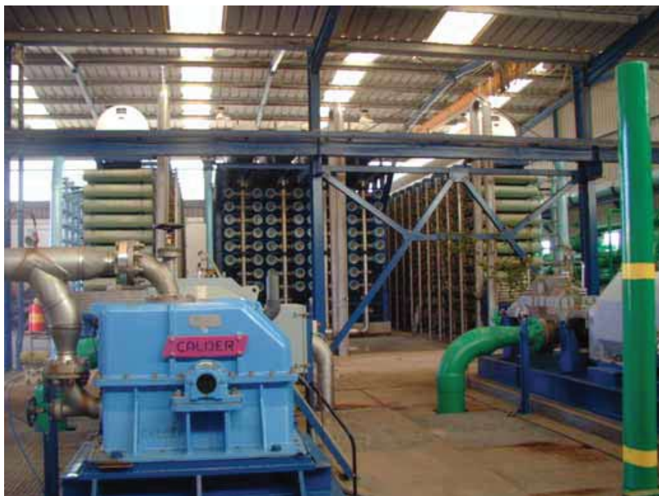
西班牙 Agragua 海水反渗透 (SWRO) 系统中的 2# RO 装置 (照片背景中位于中间的装置) 采用 FILMTEC™ 螺旋卷式膜元件进行了改造。照片近景中的设备是高压泵。(照片由 Agragua 海水淡化厂提供)
